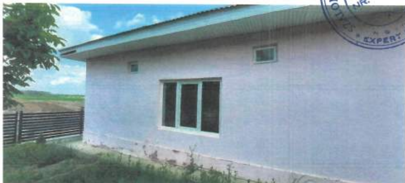
Foto 2 – fațada principală (se pot observa fisurile din pereți)
