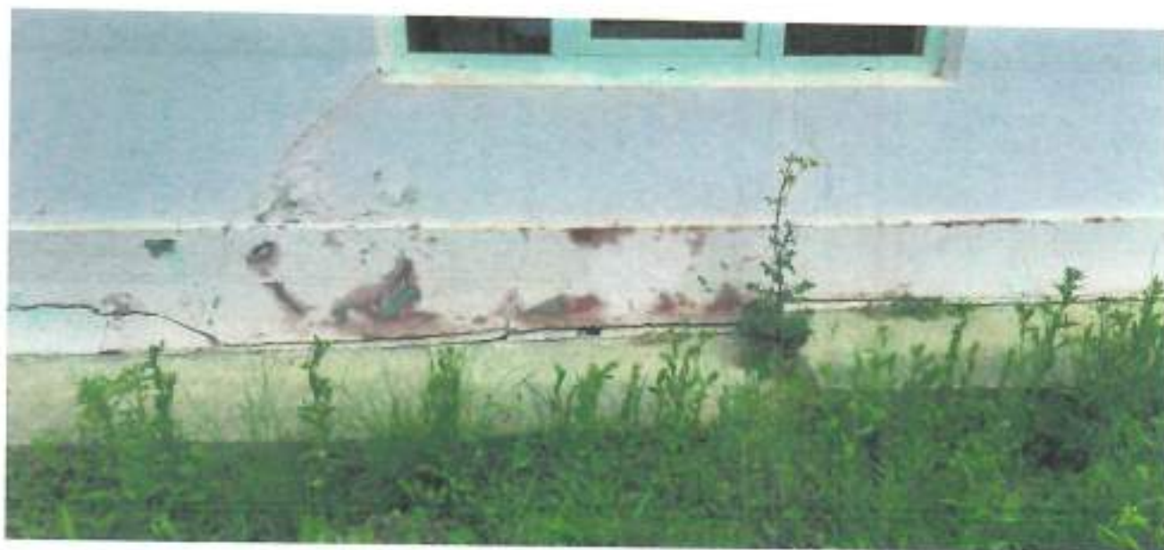
Foto 5 – infiltrații și tasări de trotuare
