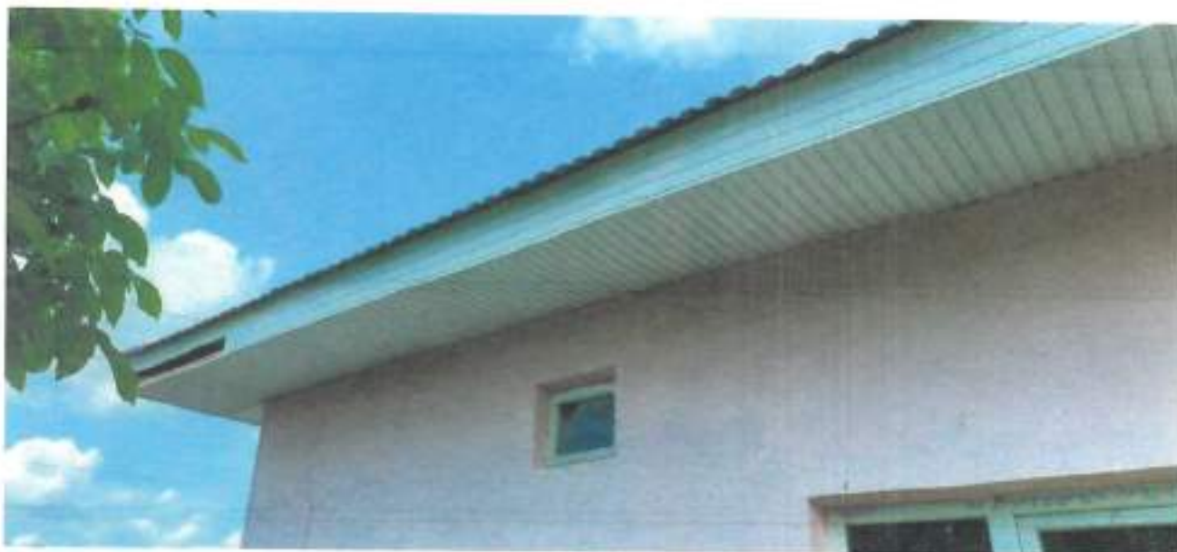
Foto 7 – lipsa sistemului pluvial
