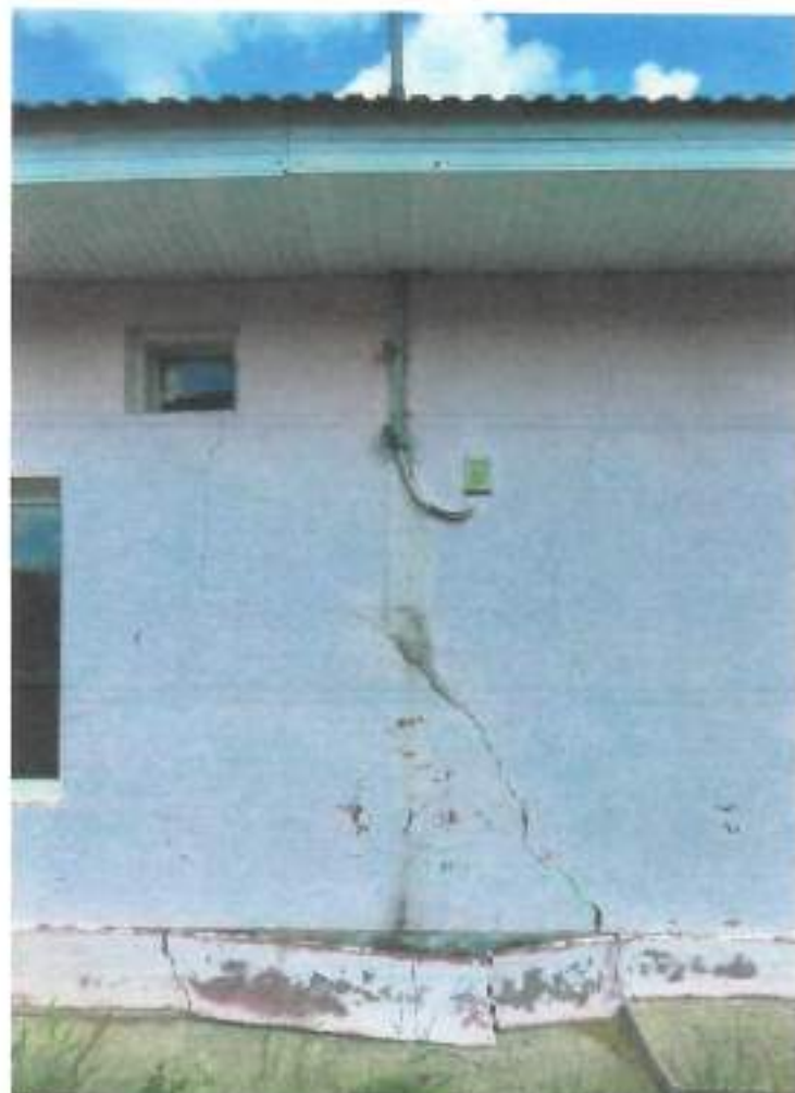
Foto 8 – infiltrații, tasări și fisuri în pereți
